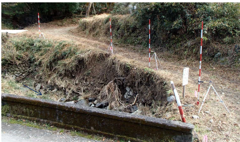
名久木川 被災事象:河床洗掘による石積護岸崩壊 (桐生市)
