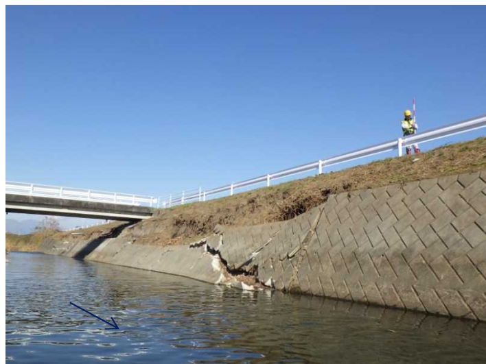
早川 被災事象: 河床洗掘による護岸挫屈崩壊 (伊勢崎)
