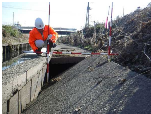
新堀川 被災事象:河床洗掘による裏込材流出 (館林市)
