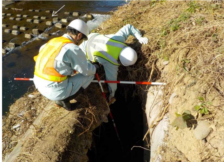
蛇川 被災事象:河床洗掘による裏込材流出 (太田市)
