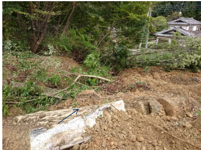
相水川 被災事象: 民有地法面崩壊に伴う河道埋塞 (安中市)
