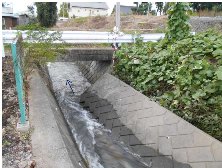
大川 被災事象:河床洗掘による護岸側倒 (太田市)
